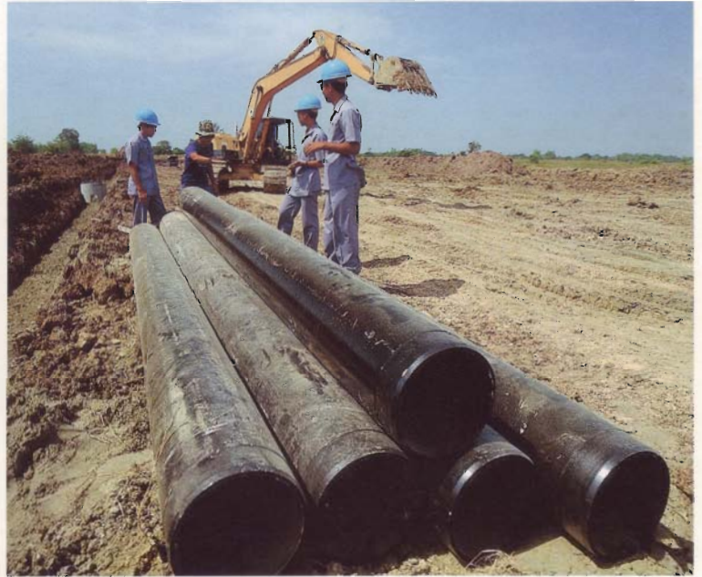
การจัดเตรียมระบบสาธารณูปโภคต่าง ๆ ในโครงการจัดสรรที่ดิน เพื่อการอุตสาหกรรมของบริษัทที่ดินอุตสาหกรรมเครือซิเมนต์ไทย จำกัด ที่อำเภอหนองแค จังหวัดสระบุรี ได้เลือกใช้ระบบที่ทันสมัยที่สุด ทั้งนี้เพื่อผลทางด้านสิ่งแวดล้อมเป็นสำคัญ
